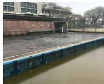
老朽化した市内の小学校のプール
